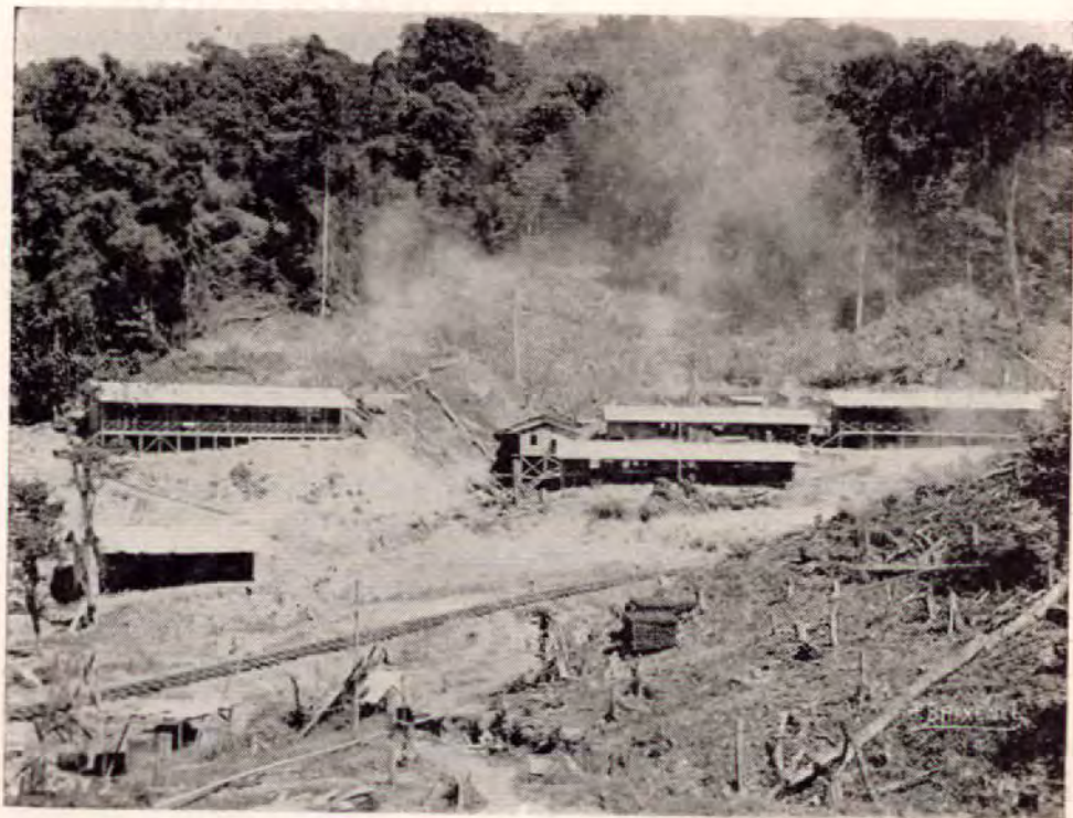
Campamentos de la Compañía Bananera de Costa Rica en la región de Punta Quepos. Ya se puede observar cómo los ingenieros van nivelando el terreno, de pura roca, para construir luego los patios de ferrocarril y demás obras del nuevo puerto.
